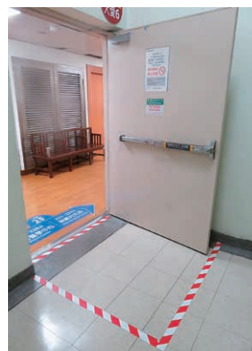
写真3: 門診(=外来)2階の避難階段への防火戸。「防火区劃の処に物を置くな!!」(日本の病院で、このラインを見た記憶がない。)
