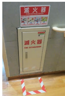
写真1: 「消火器(=消火器)」の前に物を置くな!! (日本の病院で、このラインを見た記憶がない。)
