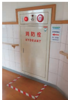
写真2: 「消防栓(=消火栓)」の前に物を置くな!! (日本の病院で、このラインを見た記憶がない。消防栓の隣のコンビニ案内板が、場違いで、可笑しい。)
